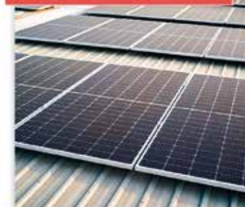
Energía Solar Fotovoltaica
