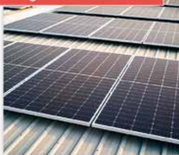
Energía Solar Fotovoltaica
