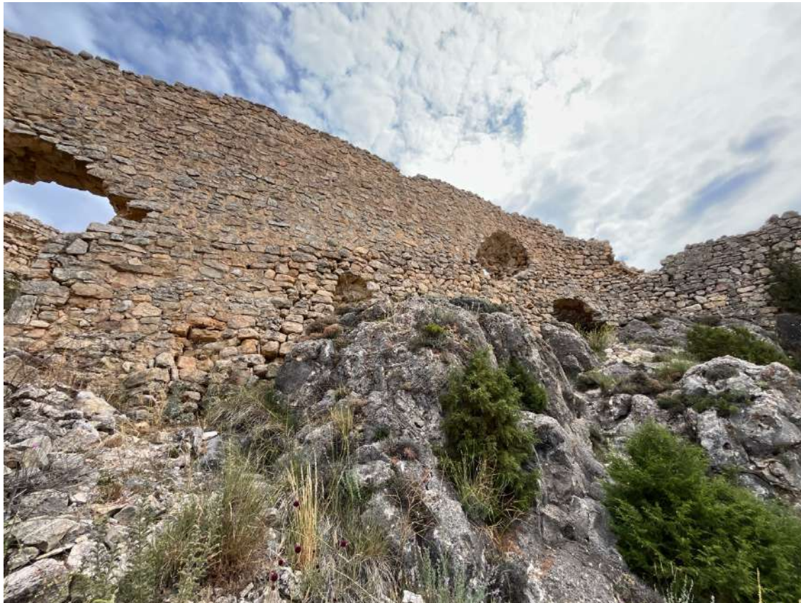
Lámina 96. Presencia de oquedades en el paño meridional del castillo M2.
