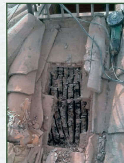
Foto 3. Cata practicada en el tejado mostrando la colmena
