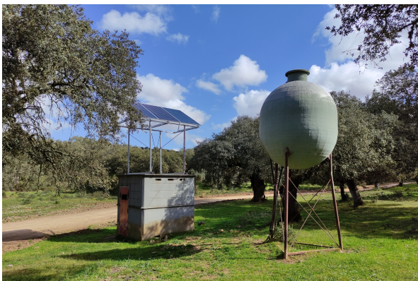
POZO DE SONDEO CON PLACAS SOLARES
