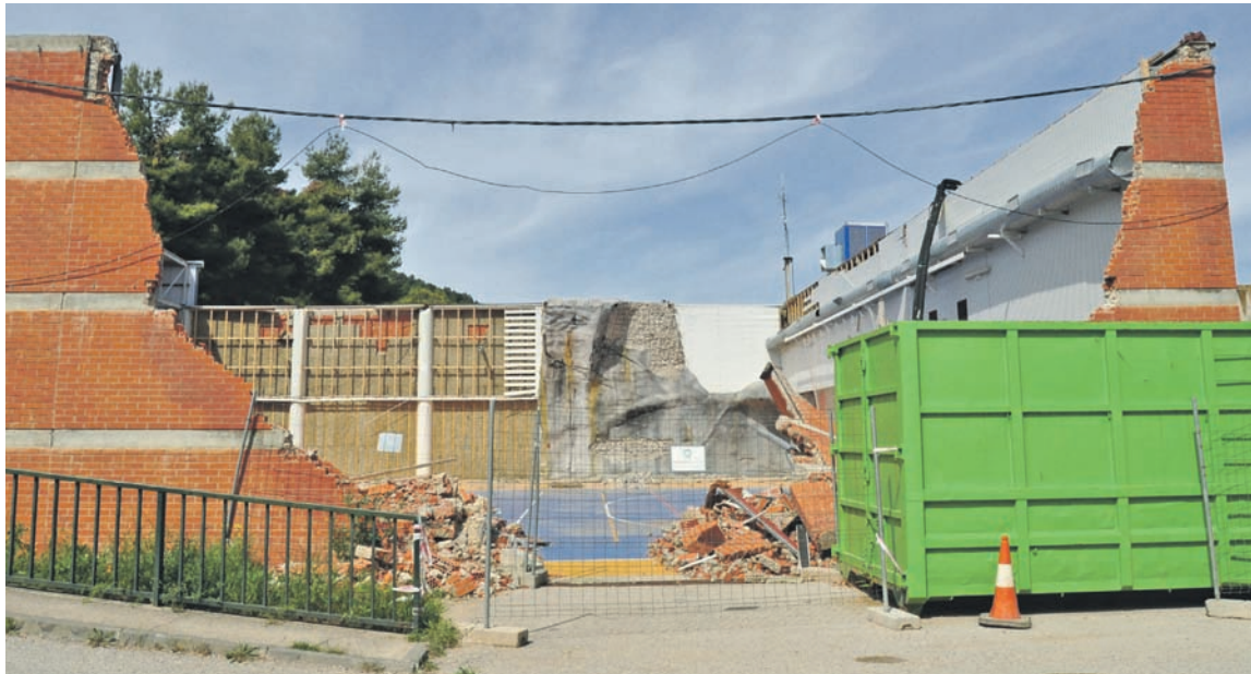
Situación actual del pabellón de Valderrobres, que era utilizado por vecinos y adultos los 365 días del año. JAVIER DE LUNA
